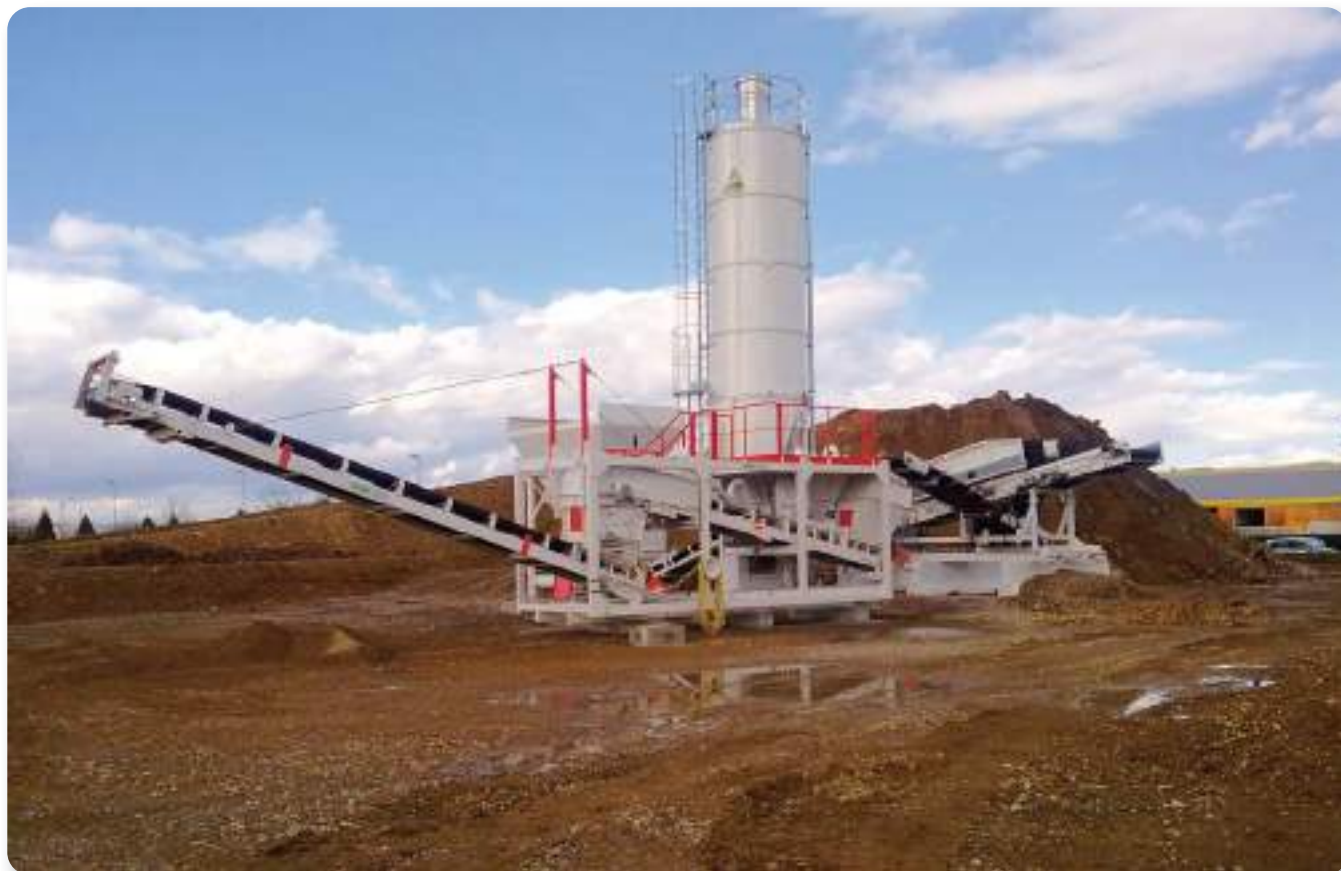
Exemple d'installation fixe - © CETE de Lyon
