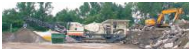
Exemple d'installation mobile
